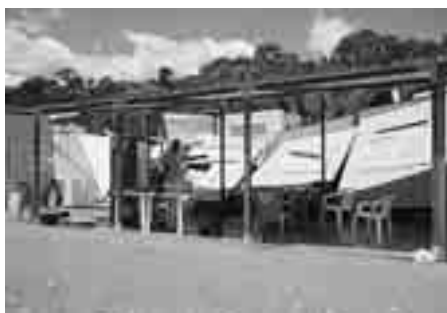
ALCUNI DEI DANNI CAUSATI DALLA TROMBA D'ARIA
