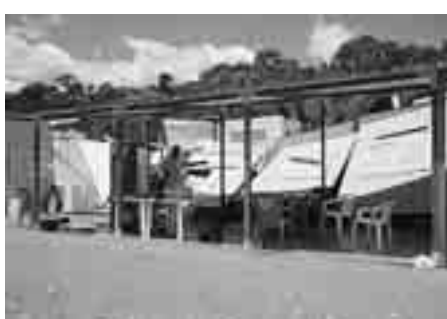
ALCUNI DEI DANNI CAUSATI DALLA TROMBA D'ARIA
